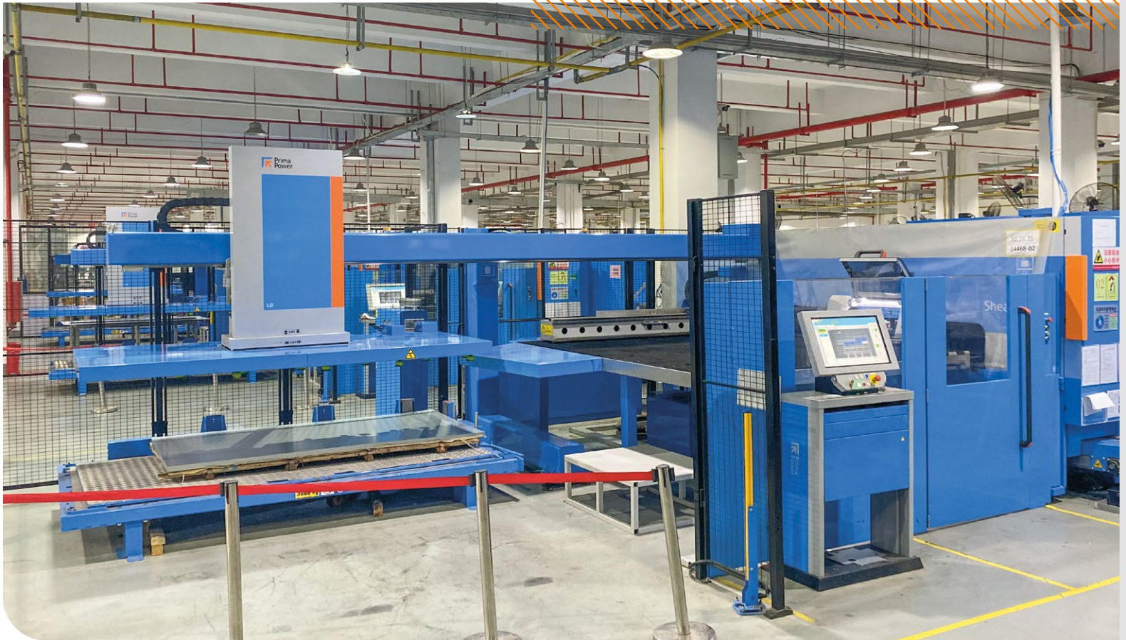
Zusätzlich zur PSBB-Linie, im SUNSEA AIoT-Werk wurden 3 Shear Genius SG 1530 Maschinen und 5 eP 1030 Abkantpressen installiert.
